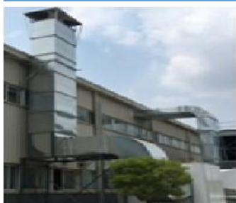
废气处理装置及排气筒
