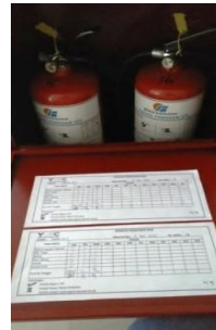
消防器材点检
