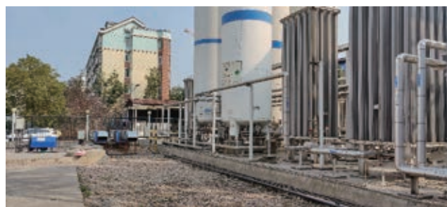
氣化器噴淋水收集裝置
